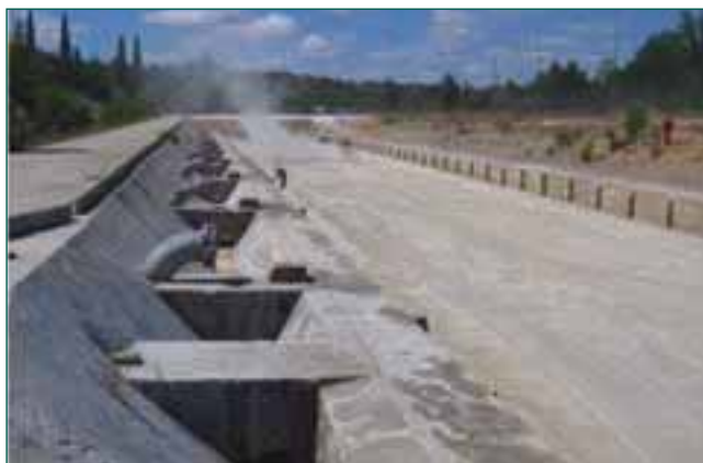
Figura 7. Explanada torres de refrigeración.
