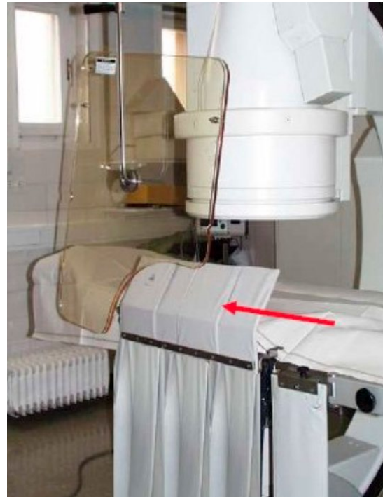
Protecciones en Fluoroscopia: protecciones plomadas, mampara colgada del techo
