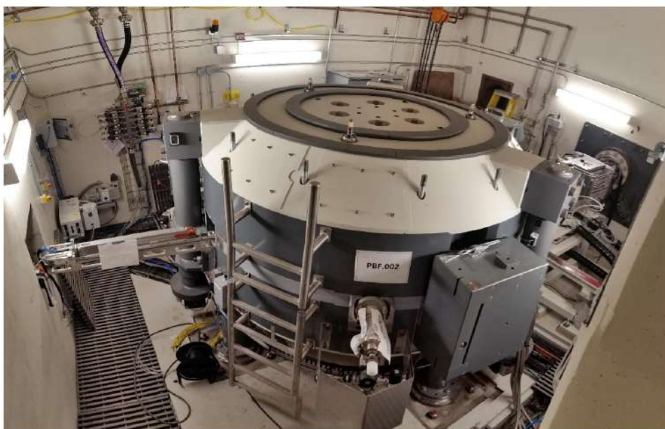
Fig. 1 - Foto de archivo de una instalación con un S2C2.
