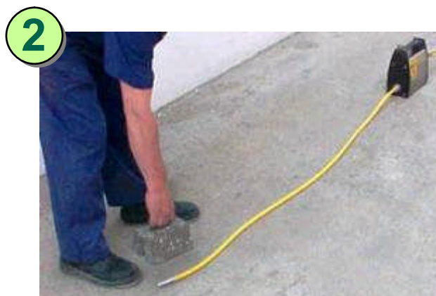
2 Colocar una teja u otro elemento de blindaje sobre la ubicación del portafuentes (extremo del puntal)
